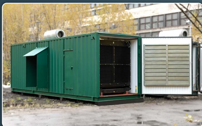
2 ДЭС по 1 200 кВт, лесопереработка
