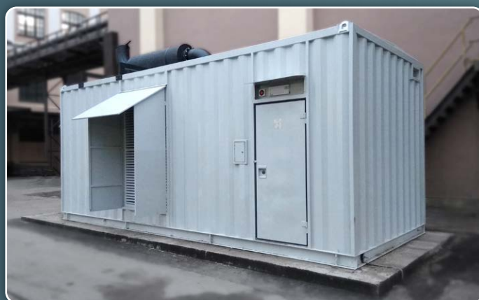
1 000 кВт, бумажная фабрика «Гознак»
