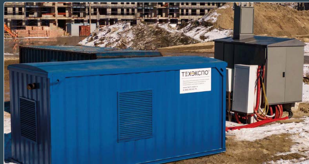
⚡ 350 кВт ДЭС 350 кВт в контейнере для строительного городка
