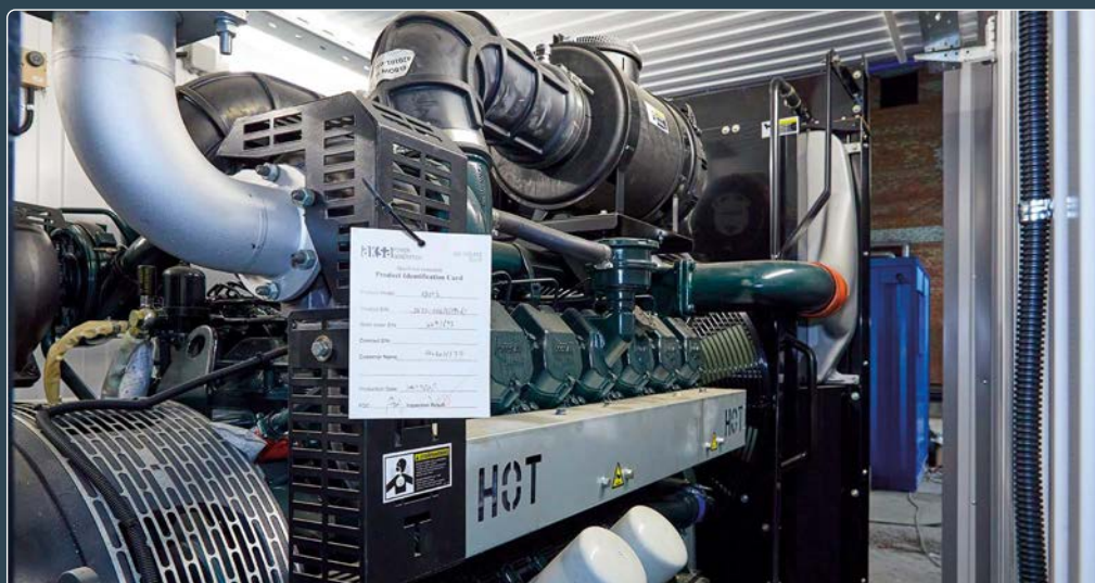
⚡ 1020 кВт ДЭС 600 и 420 кВт на Караканское месторождение
