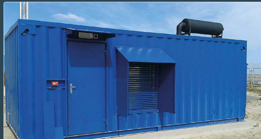
⚡ 640 кВт Cummins 640 кВт для рыбоводного завода
