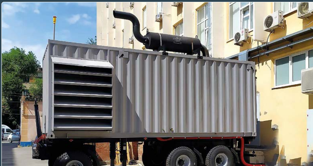
⚡ 360 кВт Передвижная ДЭС 360 кВт для коммерческого банка
