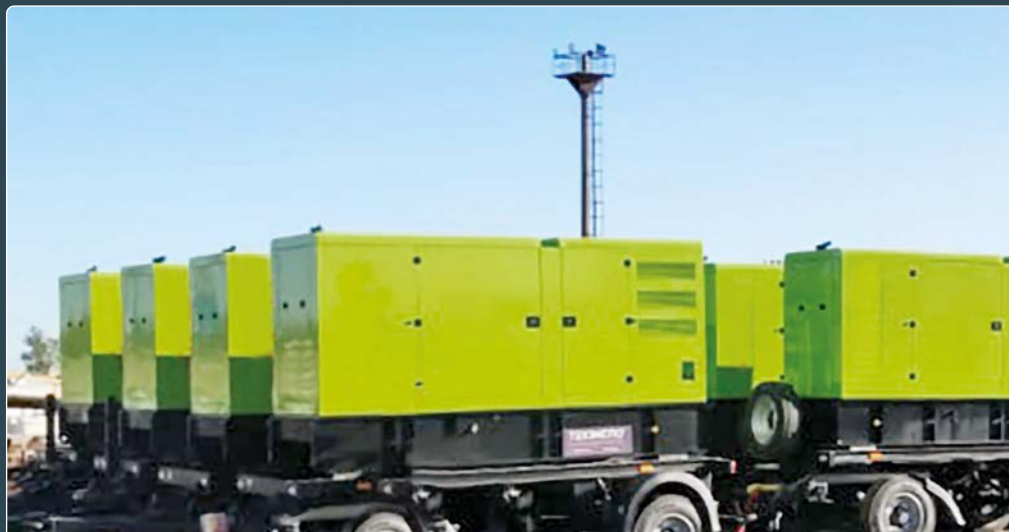
⚡ 6250 кВт 25 ДЭС по 250 кВт для электросетевой компании
