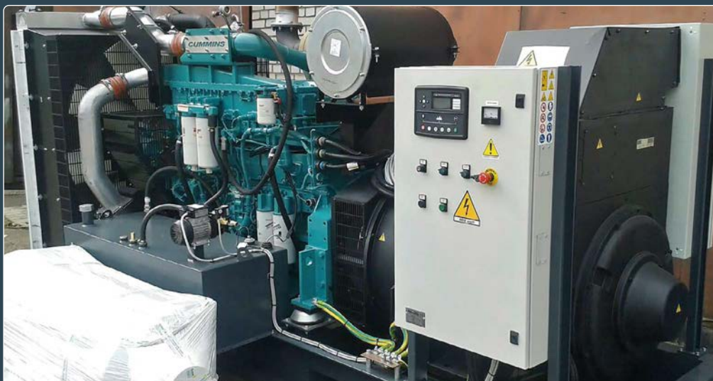
⚡ 640 кВт Cummins для компрессорного завода
