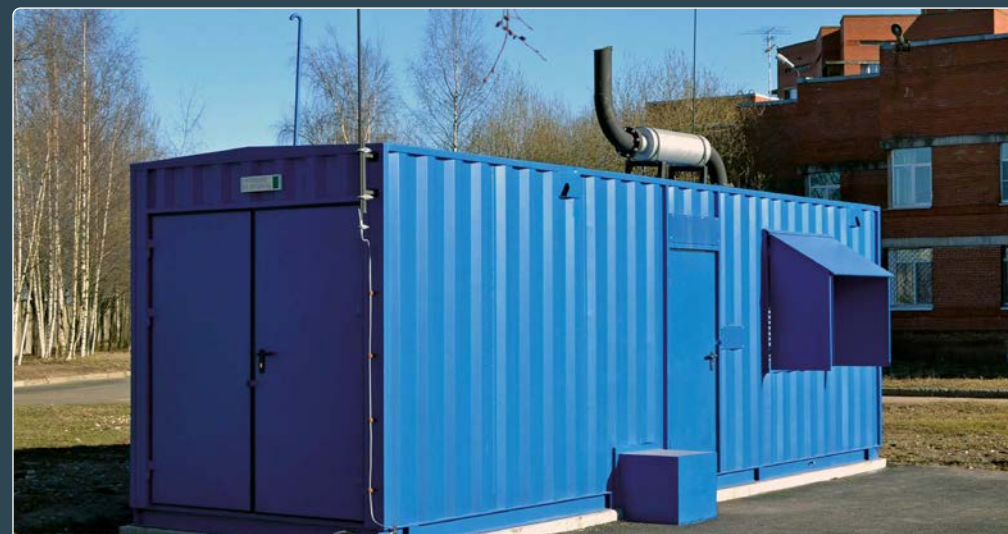
⚡ 473 кВт ДЭС Perkins для интерната
